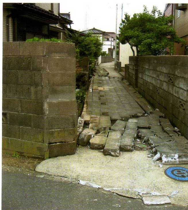
ブロック塀の倒壊
