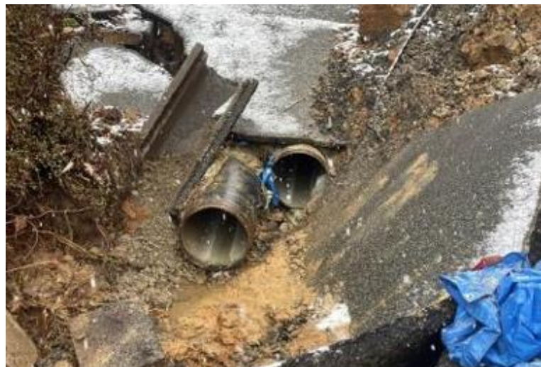
石川県輪島市 送水管被害
