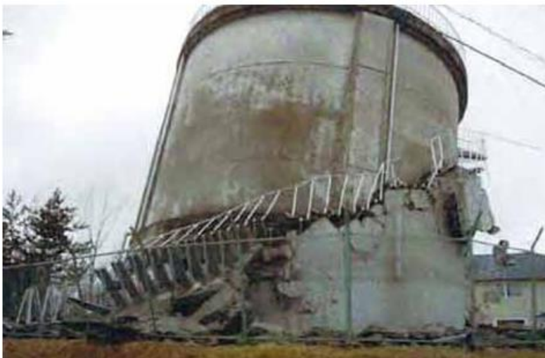
岩手県一関市 配水池被害
