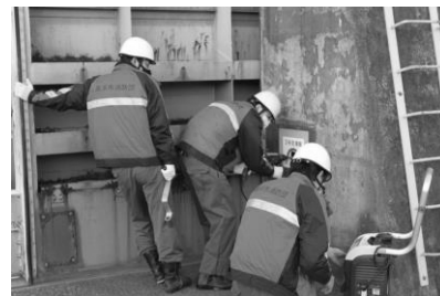
非常招集訓練（樋門等操作）
