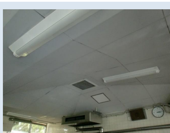
照明器具のLED化
